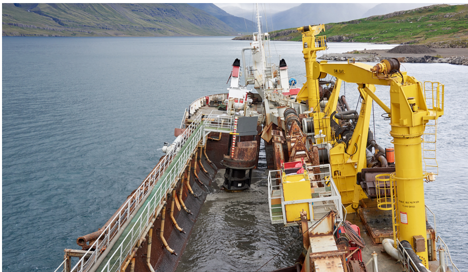
Mynd 2.5: Botninn á Galilei 2000 opnaður yfir öðrum stækkunaráfanga Mjóeyrarhafnar og efni sleppt. Þarna sést hvernig kjölur skipsins er opnaður þegar efni er sleppt í landfyllinguna.
